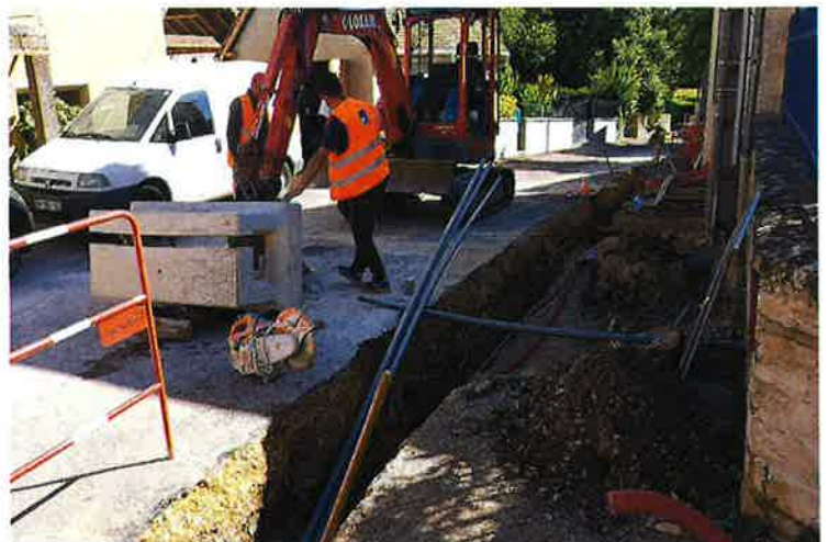
Mise en place d'une chambre de répartition des différents flux (électricité et téléphone)
